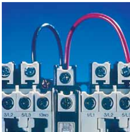
Cableado sencillo de todos los contactores
